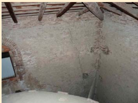
Detall àmbit on es localitzen les esquerdes del mur portant del cimbori.
