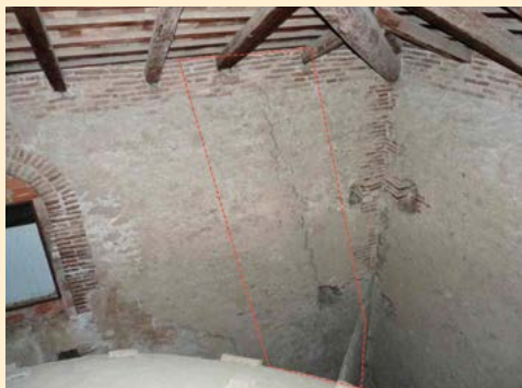
Estat actual. Mur portant cimbori amb esquerda d'entitat.
