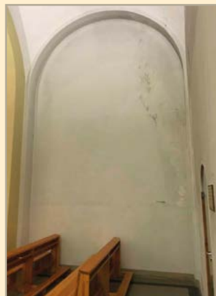
Detall parament afectat per humitats.
